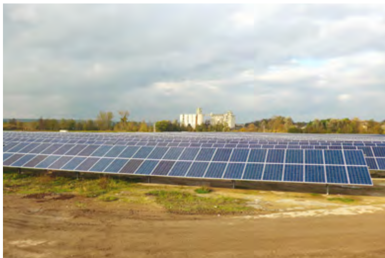
Parc solaire de Bétheniville
